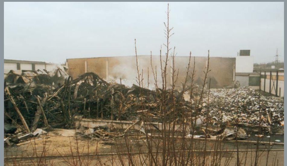
Stahlhalle mit Leichtbeton-Brandwand nach einem schweren Brand
